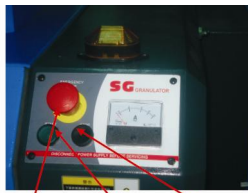
急停开关 启动按钮 停止按钮
