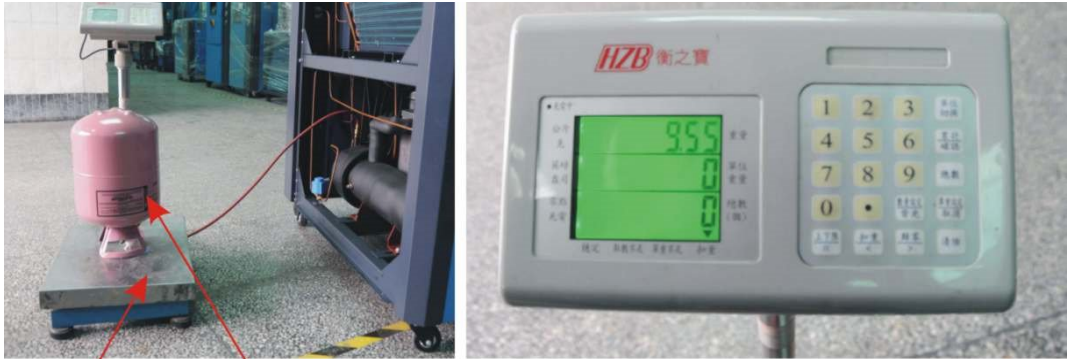
电子秤 冷媒罐
